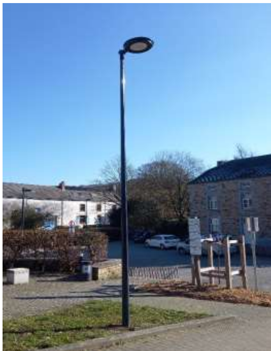
Fig. 1. Exemple d'un nouveau réverbère à l'entrée du parking du Centre. © P. André, 2025.
