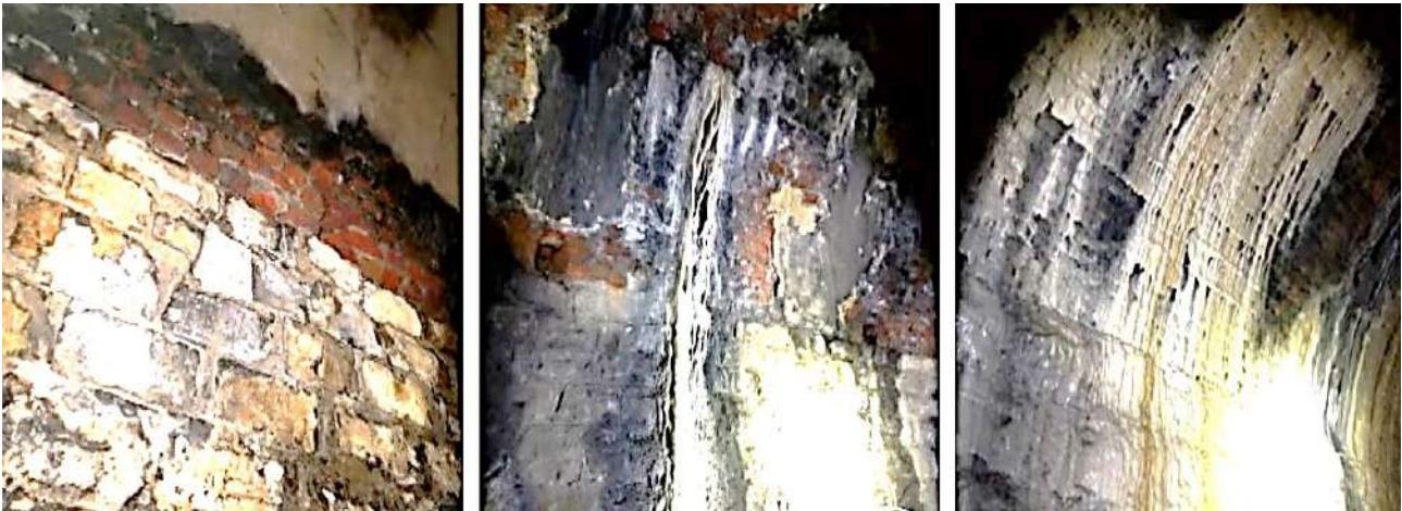
Fig. 9. Différents types de dégradations des parois et des voutes du tunnel d'Yvoir (de gauche à droite : infiltrations d'eau, fissures, calcifications et suintements). © S. Huckle, 2024.
